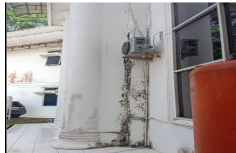
Gambar 1. Bagunan yang rusak akibat cuaca
